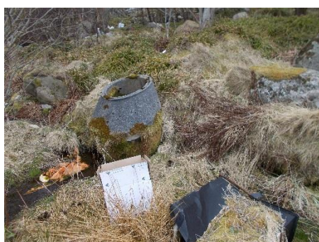
Figur 6. Kummen i nedkant av deponiet hvor det ble tatt en vannprøve. Vannet renner inn i kummen fra et rør og renner ut på bakken foran i bildet.
